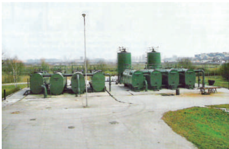
Ilustracija 8 Filtri za čišćenje vode na crpilištu Sašnjak [3]
