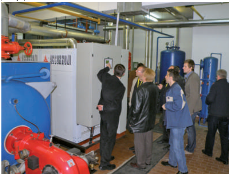
Ilustracija 9 ...kogeneracijsko postrojenje...
