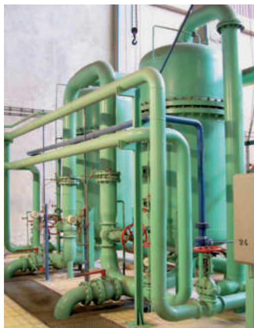
Ilustracija 8 Drenažni sustav na postrojenju pročišćavanja kondenzata
