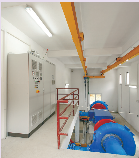
Pogled u unutrašnjost MHE Dušica u BiH-u
