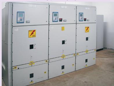
Dio SN rasklopnog postrojenja
