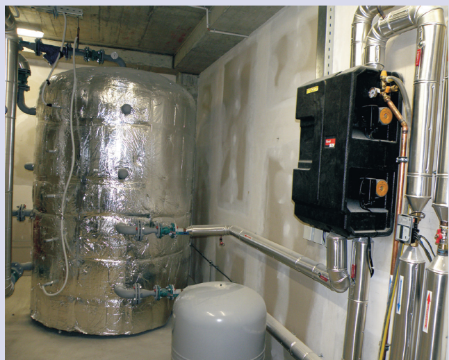
▼ Međuspremnik topline, solarna stanica i sva druga oprema u strojarnici stambenog dijela
