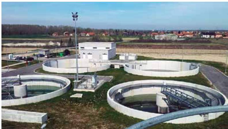
▼ ... i pročištač otpadnih voda u Dugom Selu
