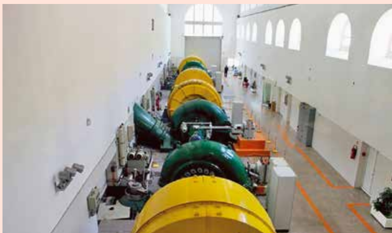
▼ Unutrašnjost strojarnice elektrane
