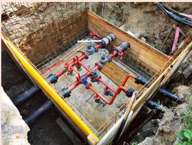
▲ Ilustracija 2 Rekonstrukcija toplovođa u Samoboru
