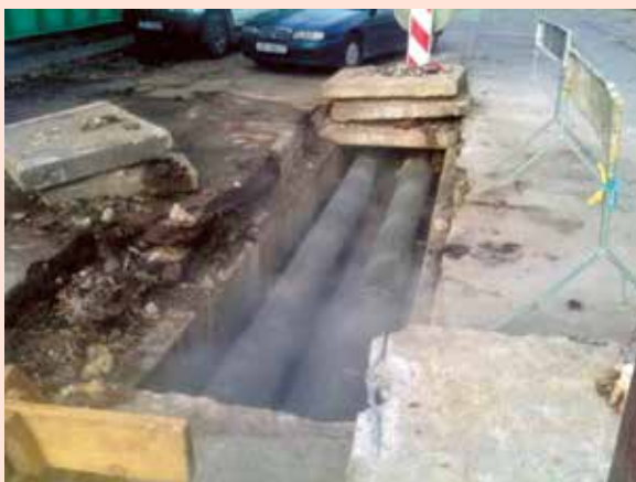
► Ilustracija 4 Vrelodovod u betonskom kanalu...
