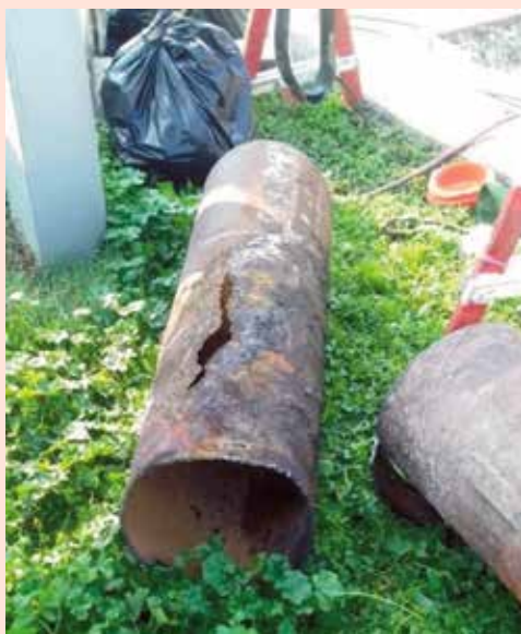
► Ilustracija 7 ... i puknuće vrelodovne cijevi
